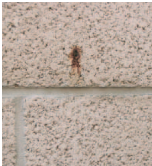
4 | Roestvlekken op gevelmetselwerk
